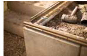
C-Schienen über Ecke montiert
