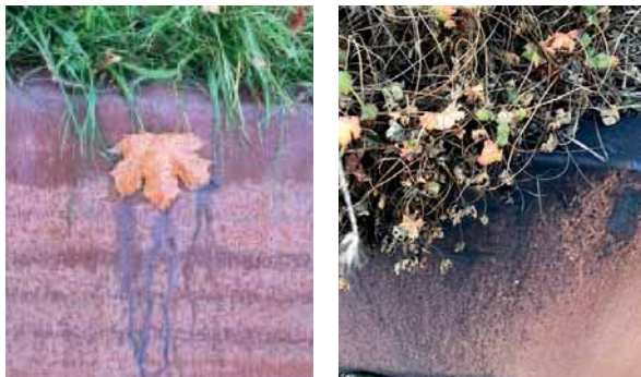
Schwarze Verfärbungen auf der Cortenstahl-Oberfläche durch organische Elemente.
